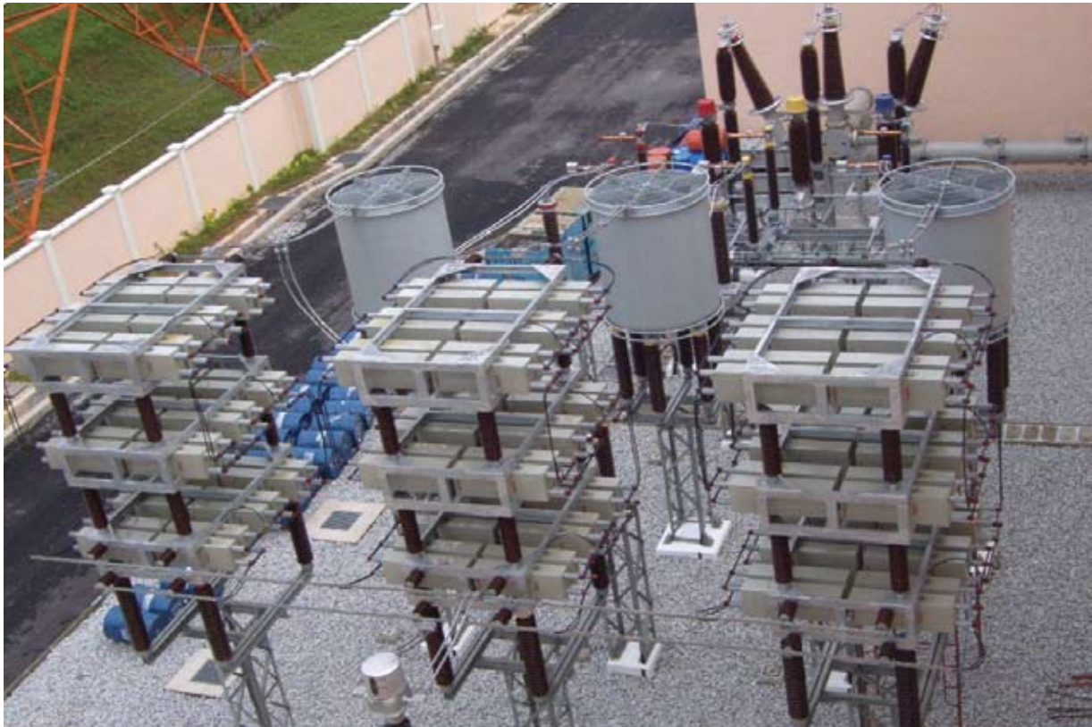
132kV 3P 50Hz 60Mvar 초고압 FUSE 내장형 콘덴서 뱅크
